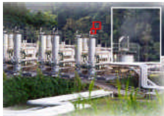
プラント監視
